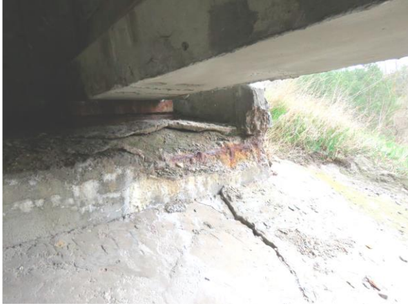
Разрушение бетона насадки опоры, оголение, коррозия
