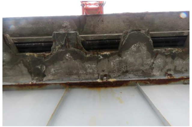
Разрушение бетона по фасадной части, наблюдаются трещины с высоломи, оголение, коррозия арматуры
