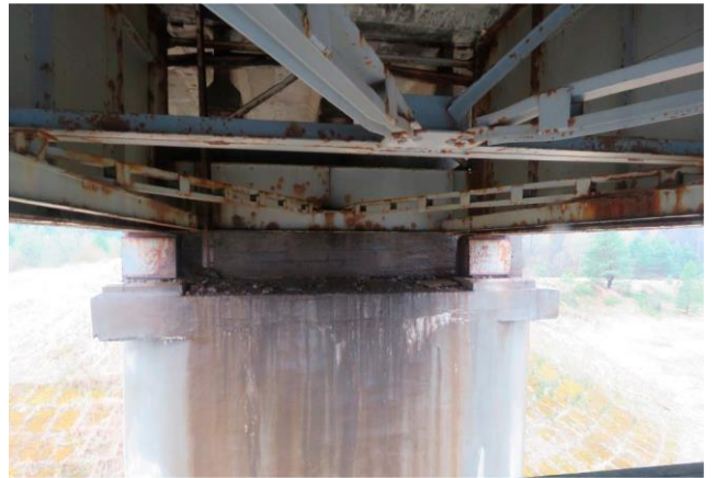
Шелушение, следы увлажнения, разрушение бетона конструкций опоры
